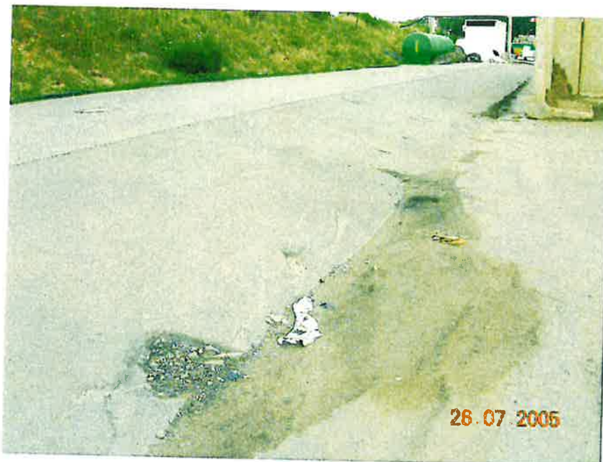
Bild Nr. 3: Kleinere, oberflächenhafte Schadstelle in der Asphaltfläche
